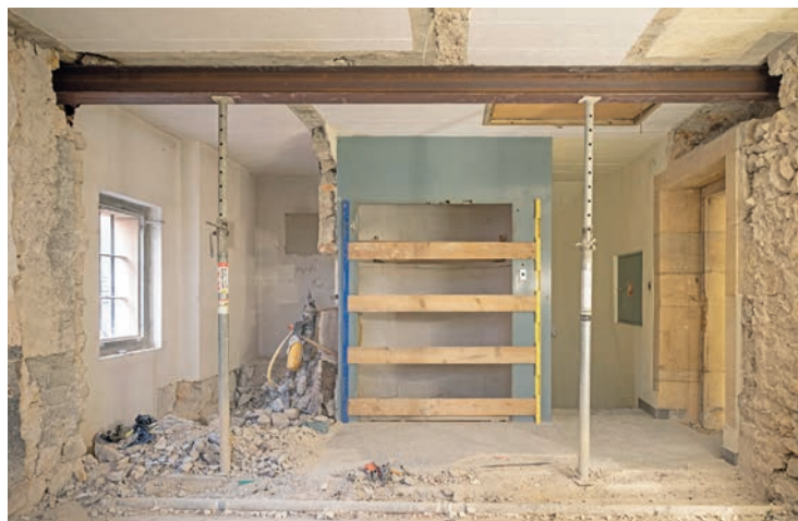
Une partie des murs de séparation des 24 cellules sont détruits pour permettre de réaménager de nouveaux espaces.
